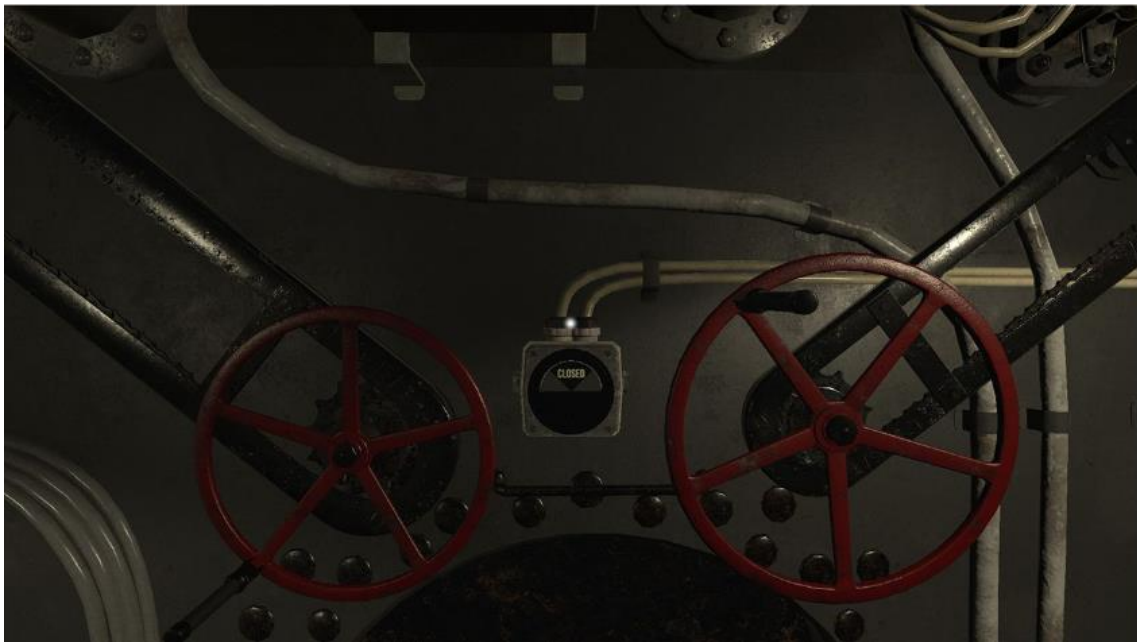
Les purges du ballast sont situées à l'avant et à l'arrière de la salle de contrôle.
