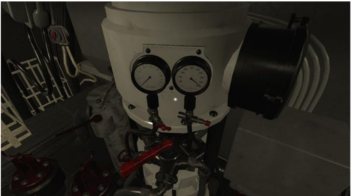
L'eau peut être pompée à l'aide de la pompe de cale.
